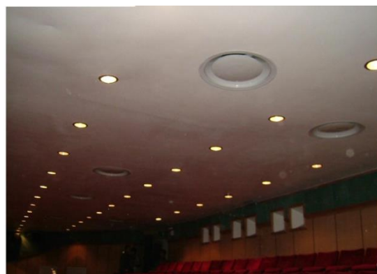
影剧院 中央空调
