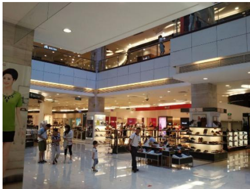
大型商场中央空调 1
