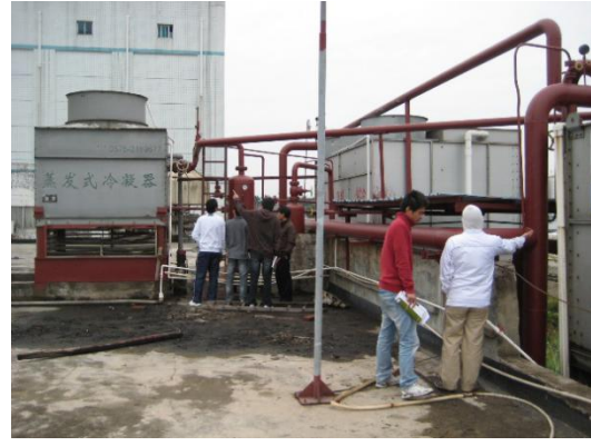
大型冷库蒸发式冷凝器 2
