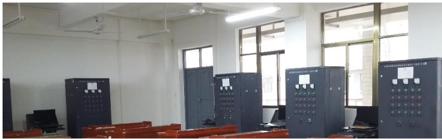
中央空调电控系统实训室
