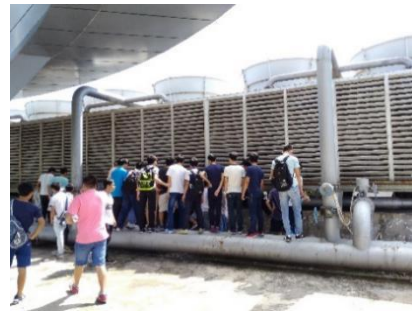
大型商场冷却塔 2
