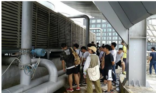
大型商场冷却塔 1
