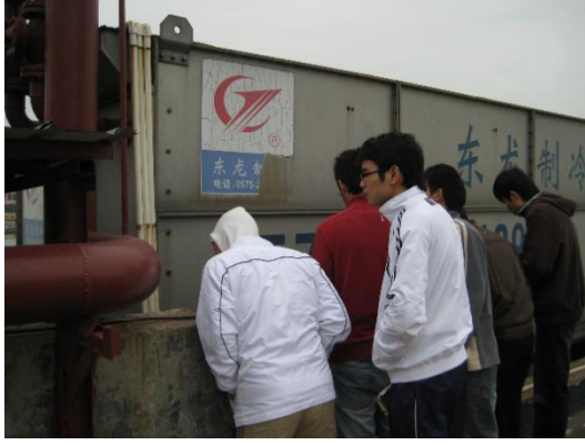
大型冷库蒸发式冷凝器 1
