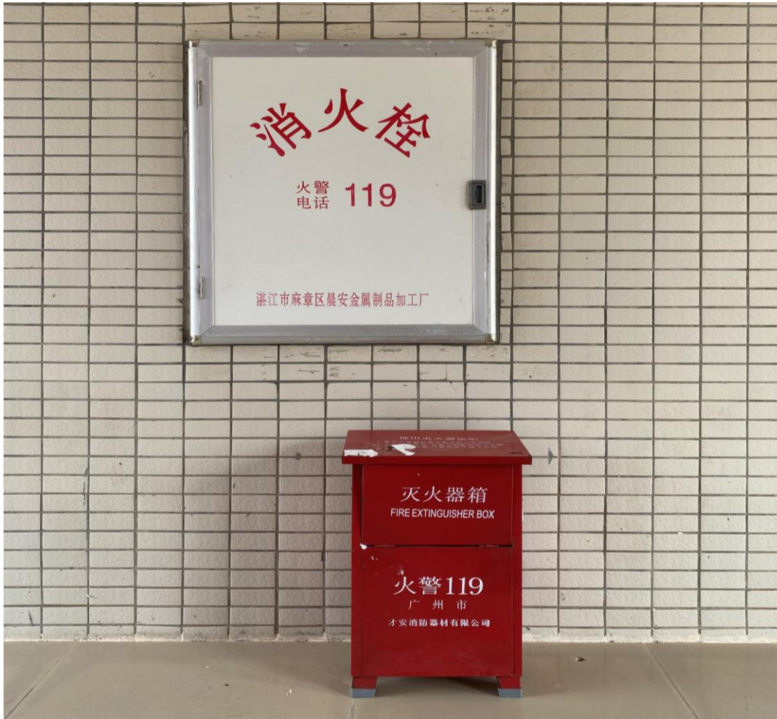
实训室消防设备、管理条例展示
