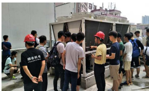
参观风冷中央空调系统
